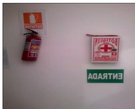
Figura 26: Extinguidores y Botiquín.
