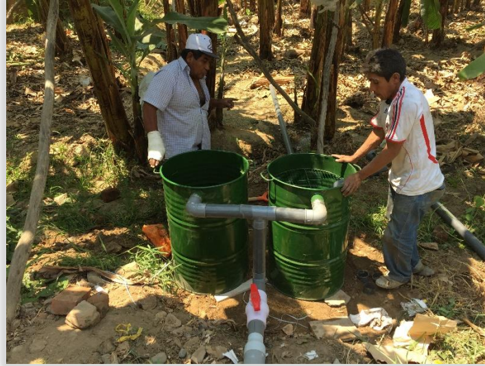
Figura 3.7 Tubería de alimentación de agua al lecho filtrante
