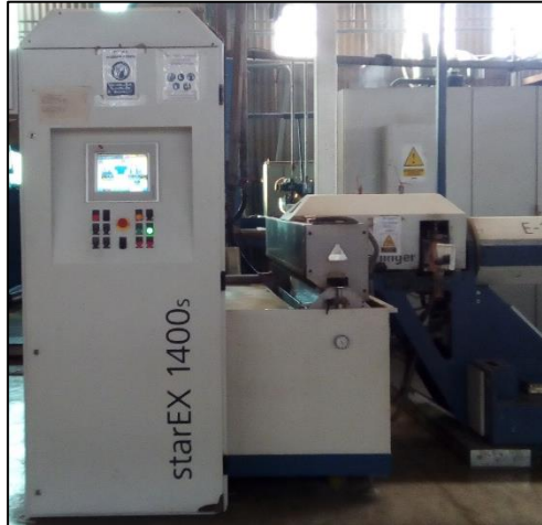
Figura 8: Matriz y pileta de agua tratada.
