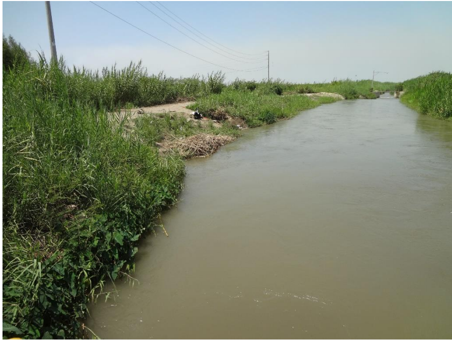
Figura 4: Canal Chiclayo Sin Revestir – Con Mucha Vegetación
