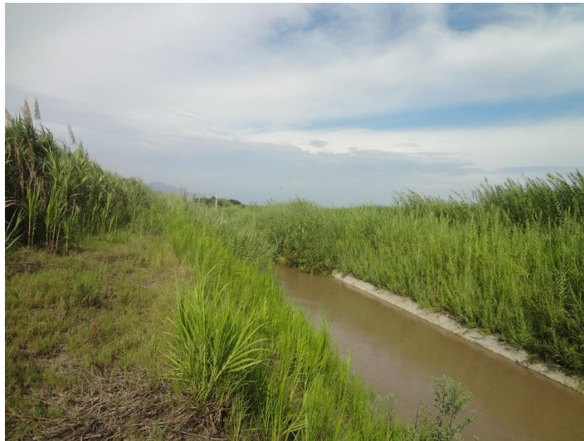
Figura 3: En mal estado aguas abajo del partidor Chéscope
