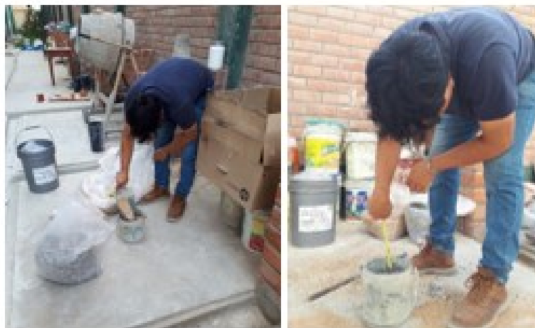
Figura. 2.17 Colocaci3n de los agregados (Arena/Confitillo) sin apisonamiento en el molde cilindrico. Fuente: Elaboraci3n propia
