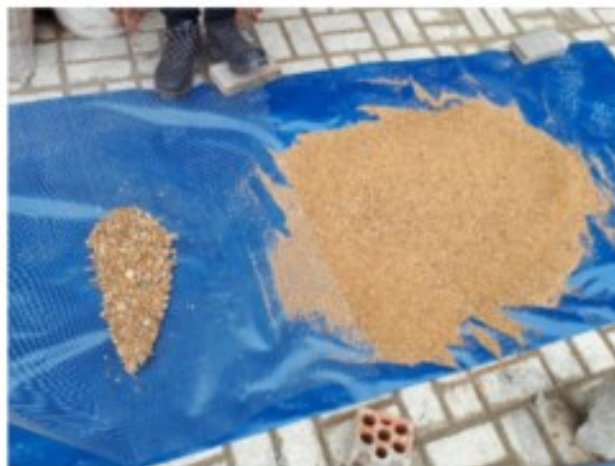
Figura. 2.7 Selección de la arena gruesa tamizada con malla metálica de \frac{1}{4} ". Fuente: Elaboración propia
