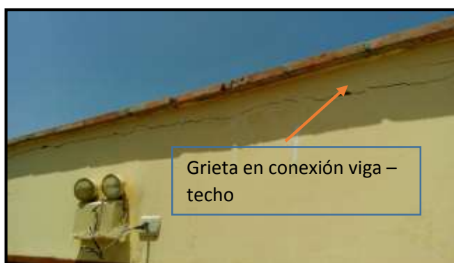
Figura 11 Gritas en la conexión techo - viga
