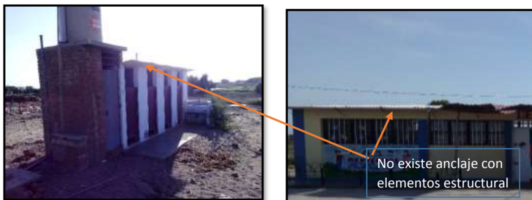
Figura 5 No existe anclaje del techo con los elementos estructurales de la edificación.
