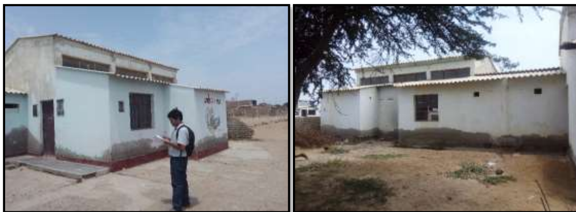
Figura 12 Erosión de muros – ausencia de elementos de confinamiento
