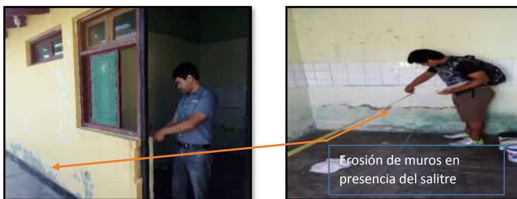
Figura 8 Erosión de muros producto de la presencia de salitre
