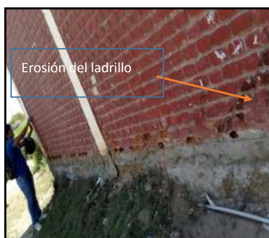
Figura 6 Erosión de las unidades de albañilería.
