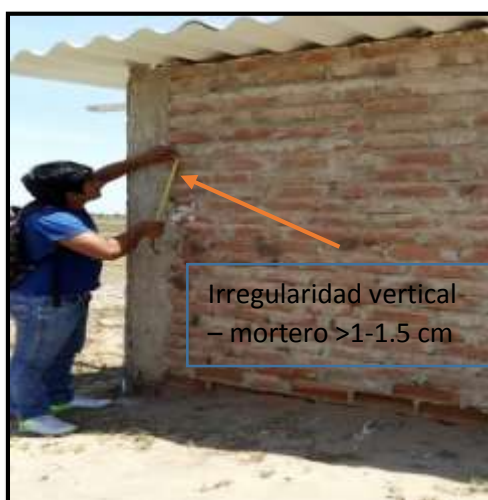
Figura 10 Irregularidad vertical – espesor de mortero > 1-1.5 cm
