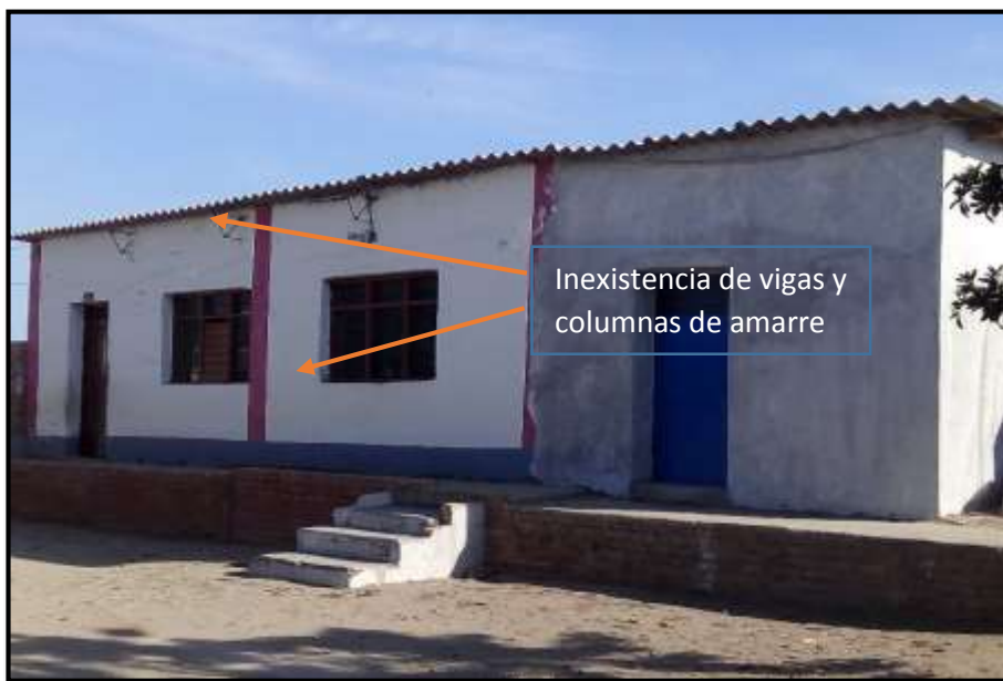
Figura 3 Inexistencia de vigas y columnas de confinamiento
