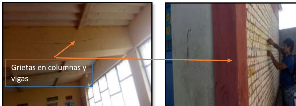
Figura 4 Grietas en columnas y vigas de la edificación.
