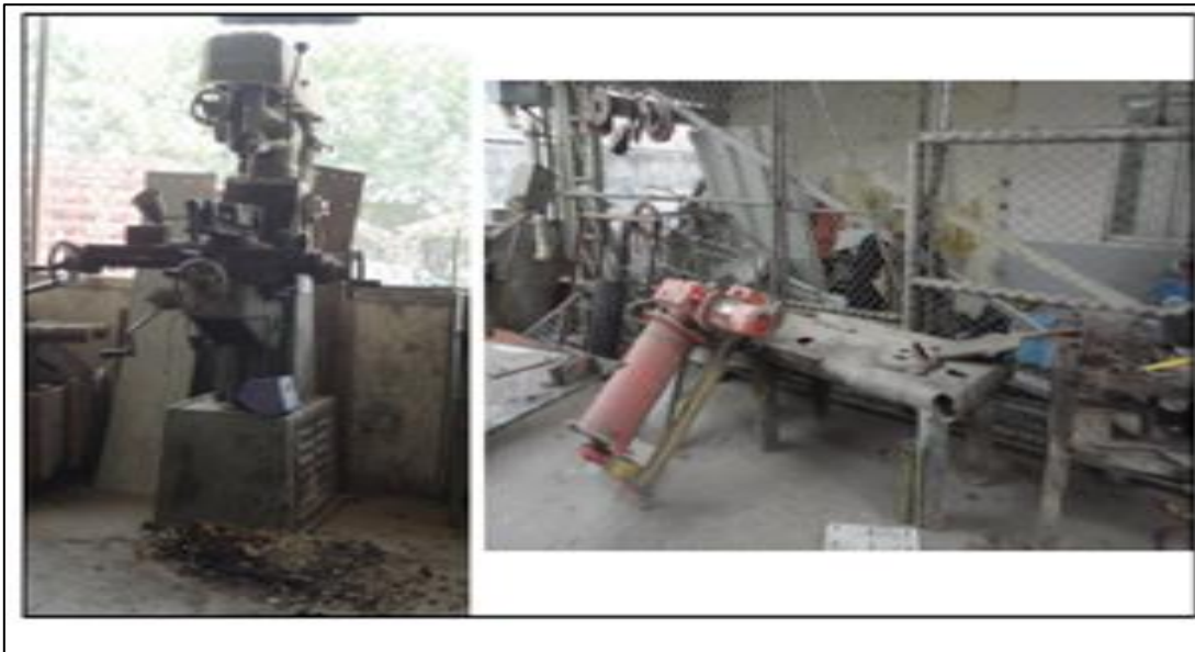
Figura 50: Equipos y materiales en mal estado del taller eléctrico Fuente: Elaboración propia.
