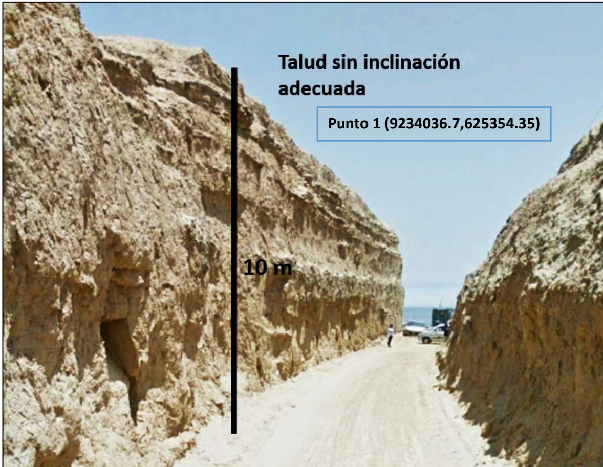
Anexo 2. La forma del talud una característica que provoca deslizamiento.
