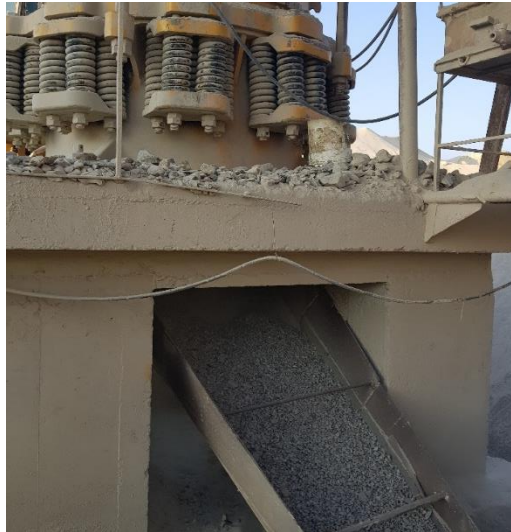
Figura 7. Concreto reciclado saliendo del tambor de máquina trituradora de la planta de procesamiento de Piedra Azul SAC.
