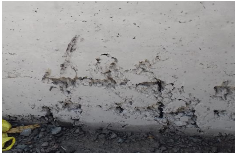
Figura 4. Cangrejas afectando la parte estructural de muros de corte y columnas.
