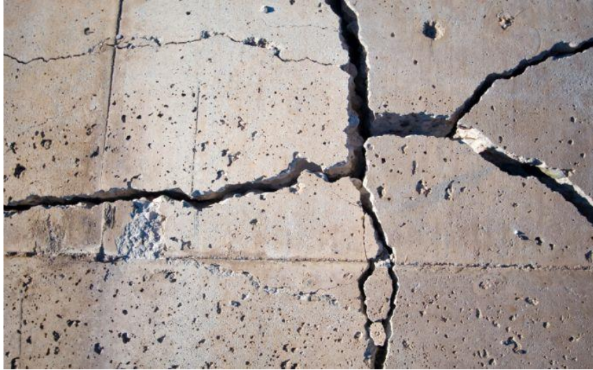
Figura 2. Cangrejeras originadas en estado endurecido del concreto.
