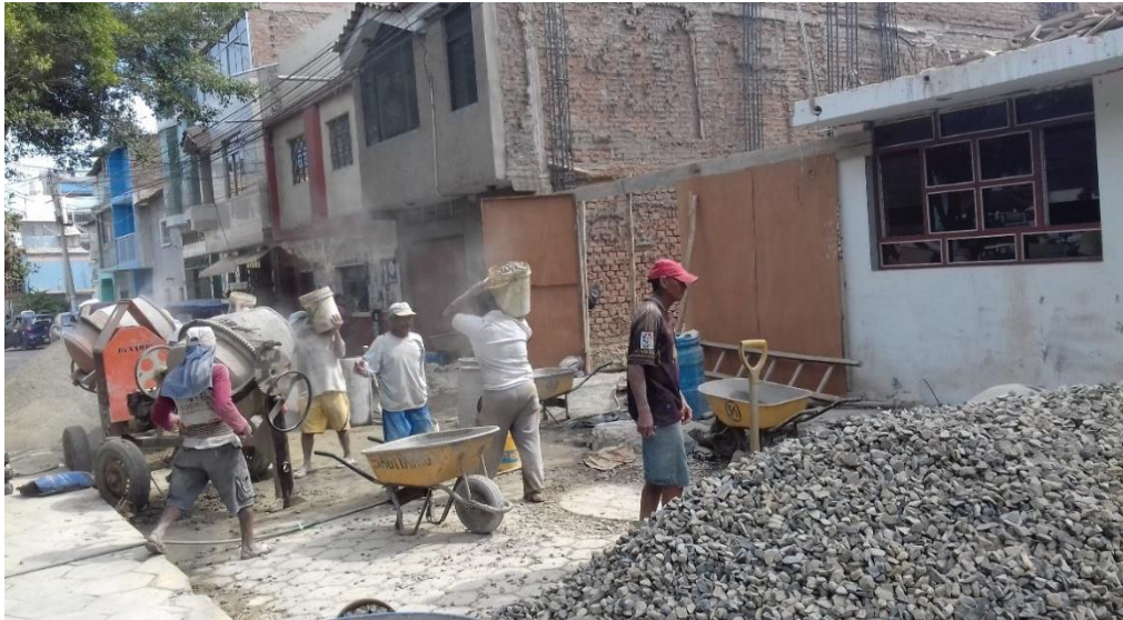
Figura 3. Informalidad en las construcciones, falta de equipo de protección personal a los trabajadores.
