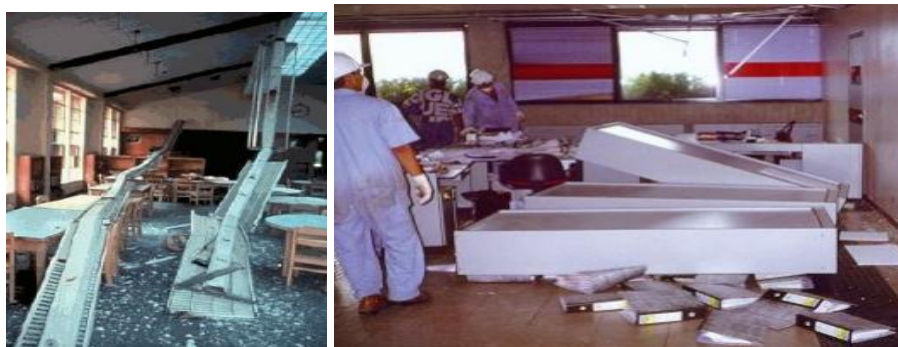
Figura 14. Colapso de elementos no estructurales en escuelas durante sismos
