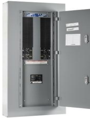
Figura 39. Tablero de control de iluminación y voltaje.
