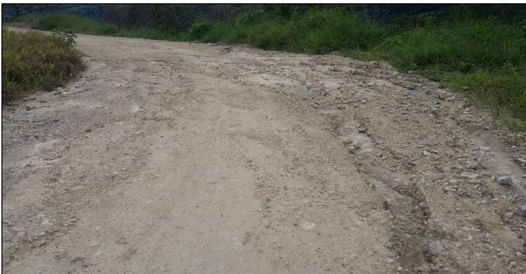
Figura 6. Deterioro de la estructura de la carretera.
