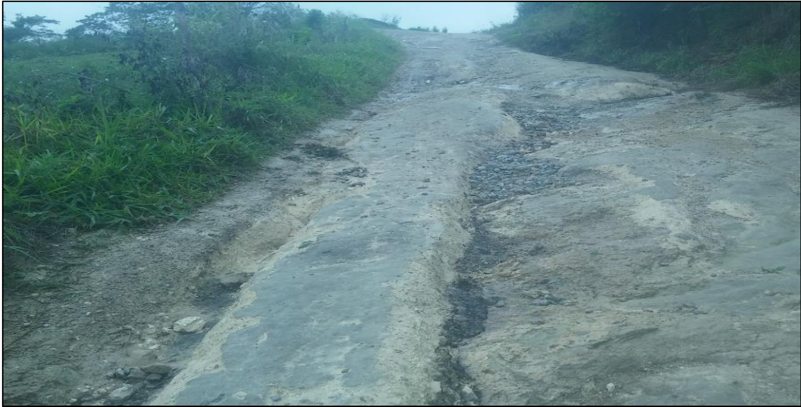
Figura 3. Carretera deteriorada antes del mantenimiento a nivel de afirmado
