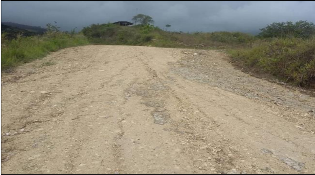
Figura 7. Pérdida de finos y aparición de surcos en la carretera.
