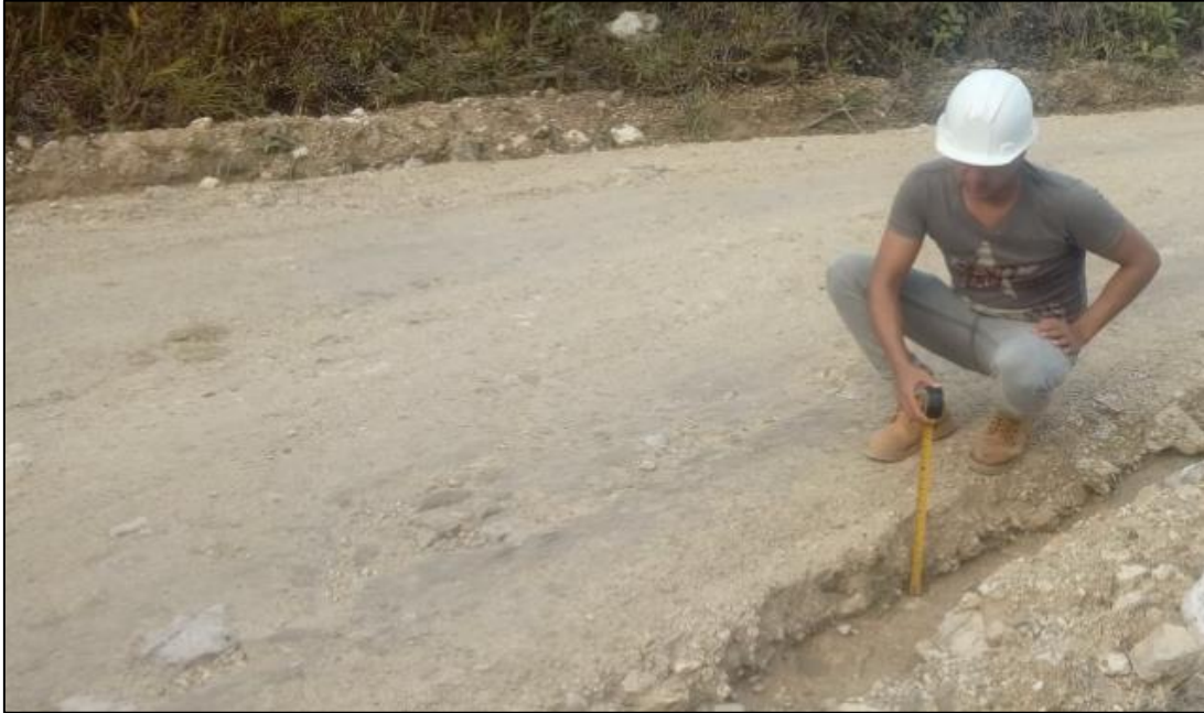
Figura 5. Presencia de surcos en la estructura de la carretera
