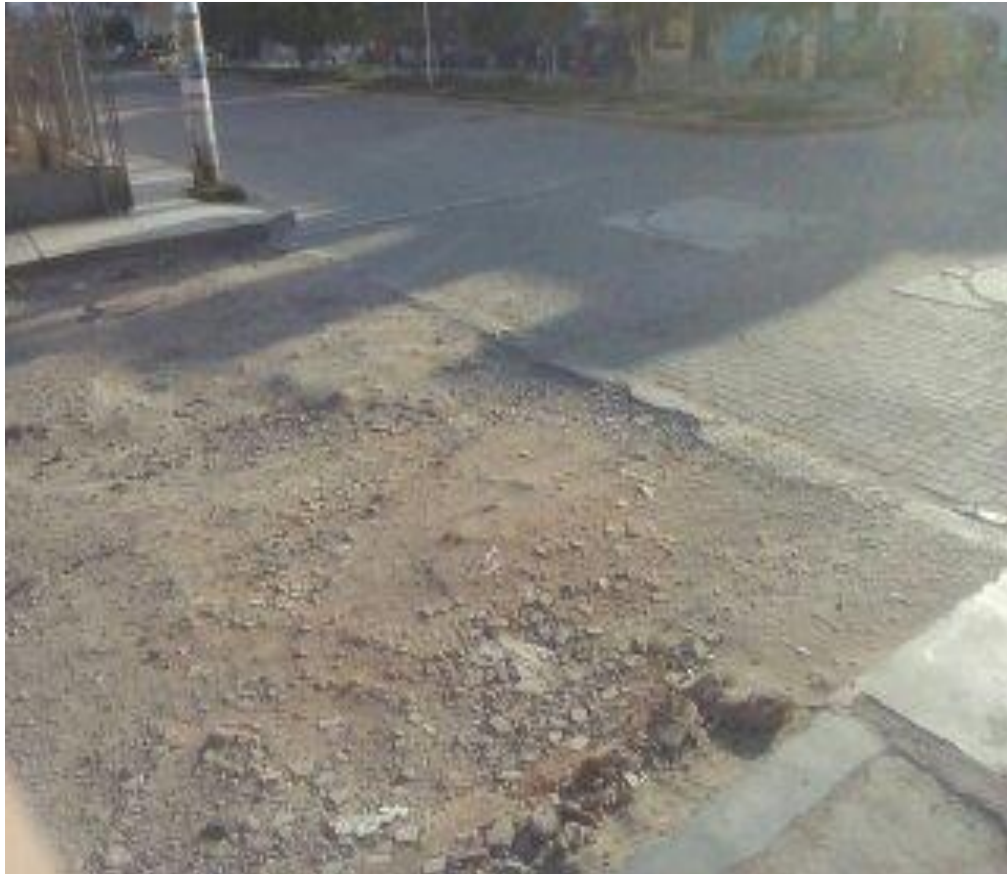
Figura 4. Pavimento deteriorado entre las avenidas México y Sáenz Peña.
