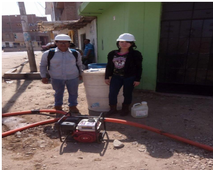
Figura 69. Cilindros de capacidad de 50 galones y motobomba de 2”.
