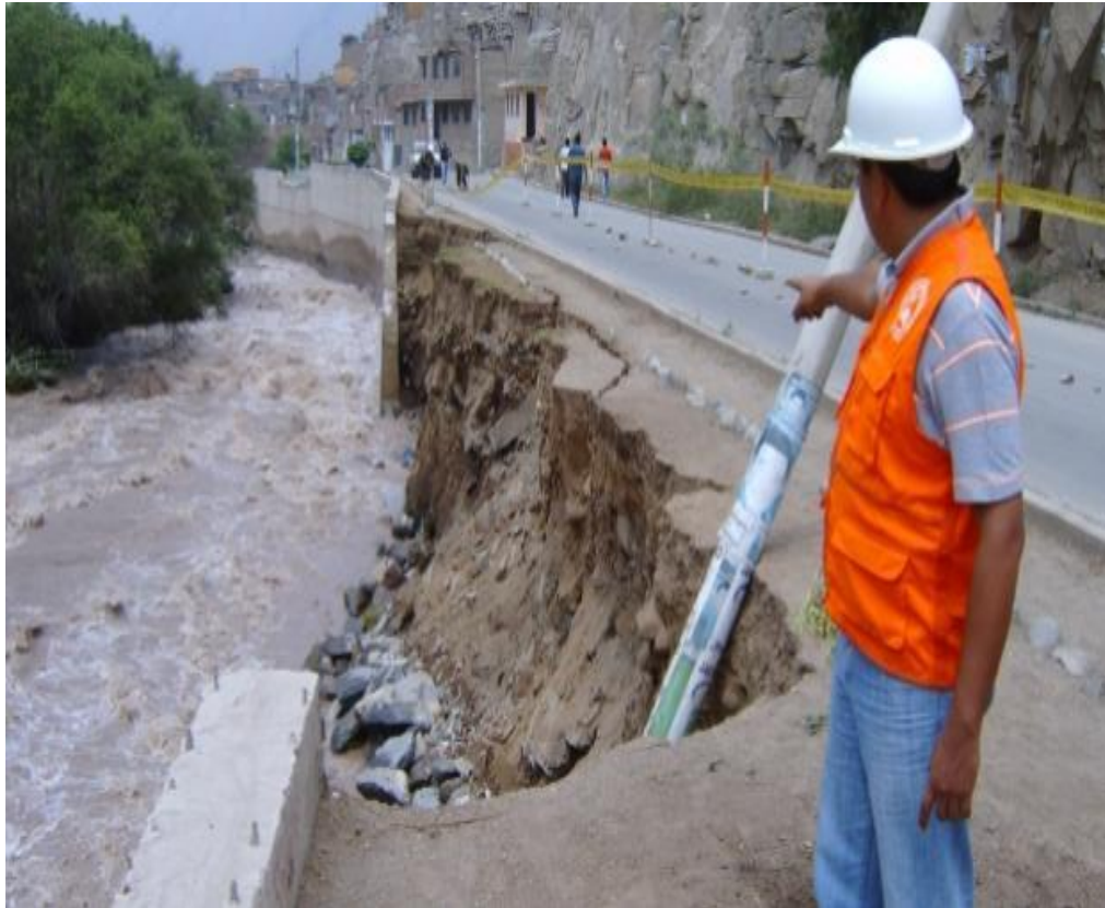
Figura 2. Mal estado de vías de transporte en el Perú.
