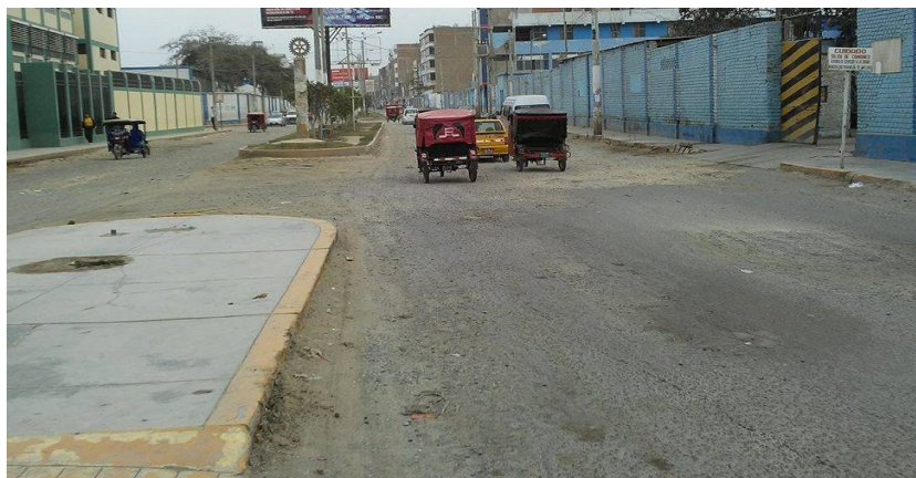
Figura 1: Deterioro de la Av. Sáenz Peña
