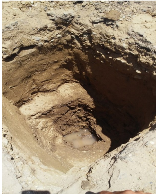
Figura 6 Estratos de la calicata N°01
