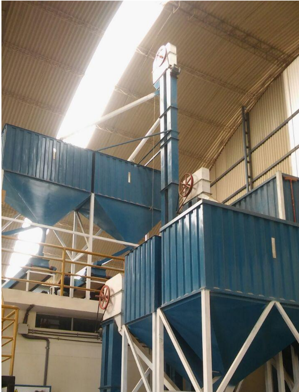
Figura 14: Maquinaria sin guardias de seguridad
