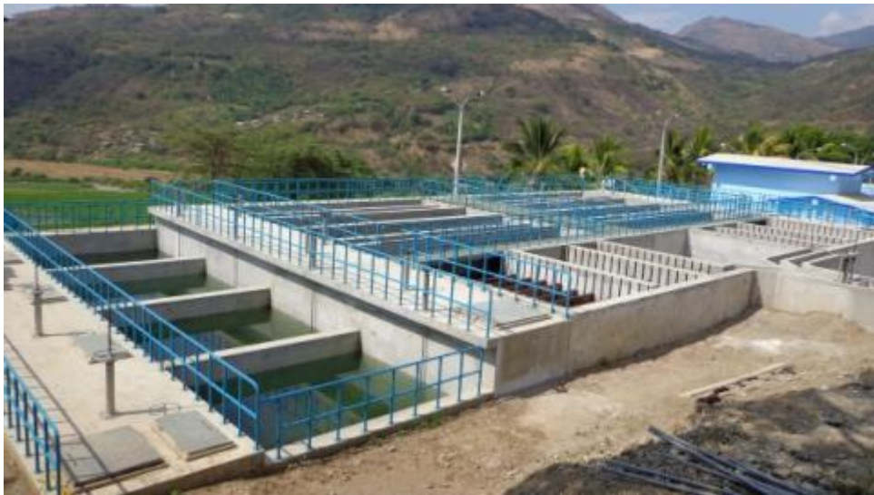
Figura 75. Planta de tratamiento de Jaén Fuente: Adaptado de EPS MARAÑON, 2016.
