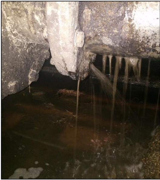
Figura D.1.85. Fuga de jugo clarificado.
