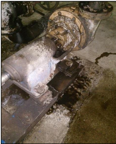
Figura D.1.81. Fuga de jugo clarificado.
