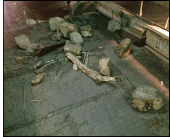
Figura D.1.54. Impurezas sacadas en conductores.
