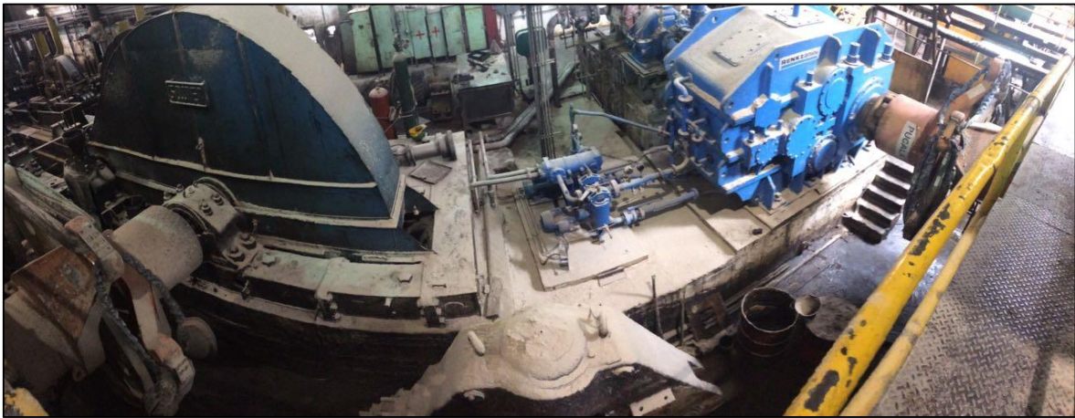
Figura D.1.73. Turbinas sucias.
