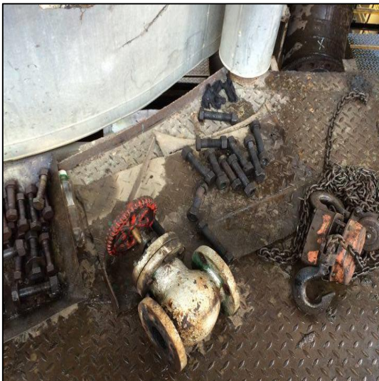
Figura D.1.87. Válvulas y herramientas mal ubicadas.
