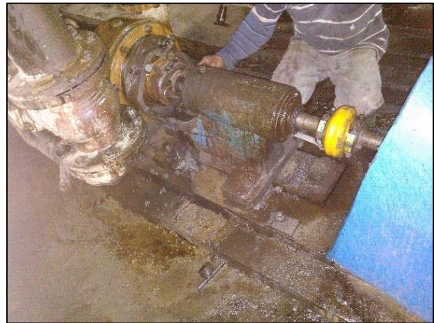
Figura D.1.82. Fuga de jugo clarificado.
