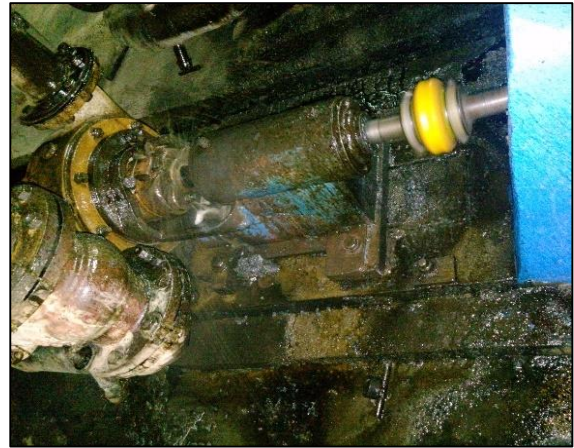
Figura D.1.80. Fuga de jugo clarificado.
