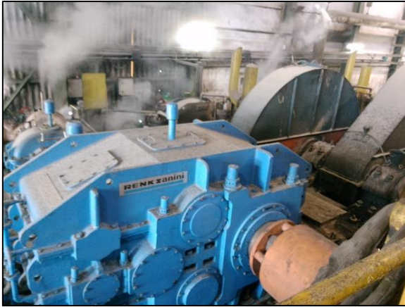
Figura D.1.59. Turbinas y reductores sucios.
