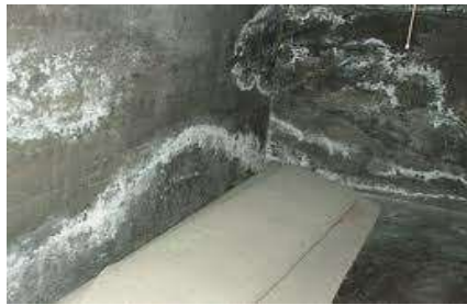
Figura 11. Eflorescencias en las paredes
