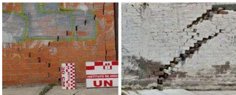
Figura 8. Grietas en albañilería confinada y convencional
