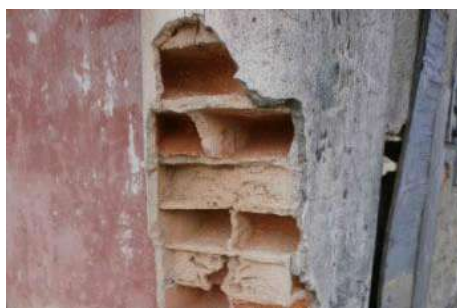
Figura 2. Erosiones recurrentes en los muros
