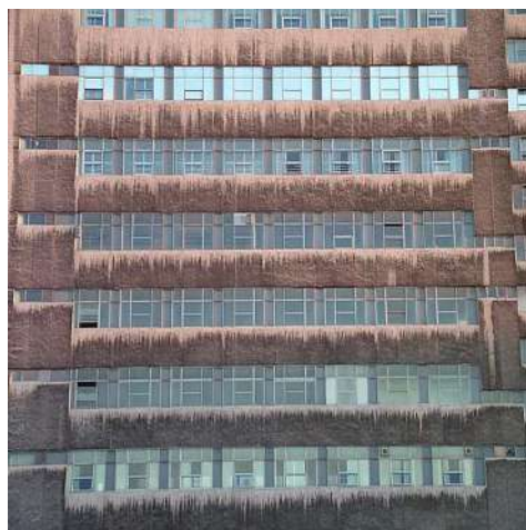
Figura 3. Suciedad en una edificación
