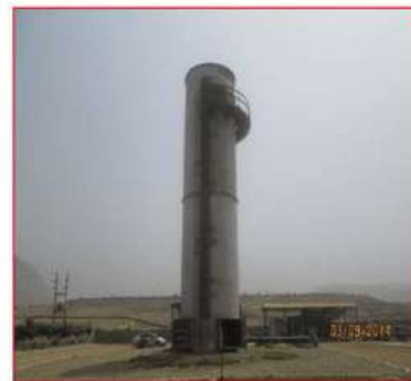
Estación de quemado de gas
