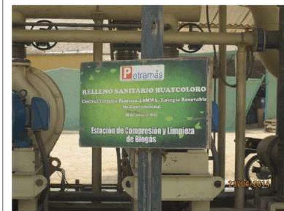
Sistema de compresión y limpieza de Biogás
