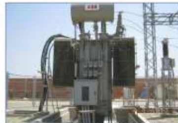
Transformador ABB de 42 MVA 60/13,8 kV
