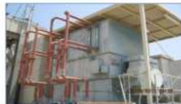
Generador Eléctrico ABB de 30 MW
