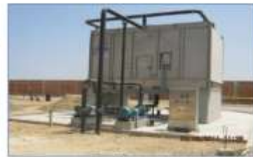
Torre de Enfriamiento de la Planta
