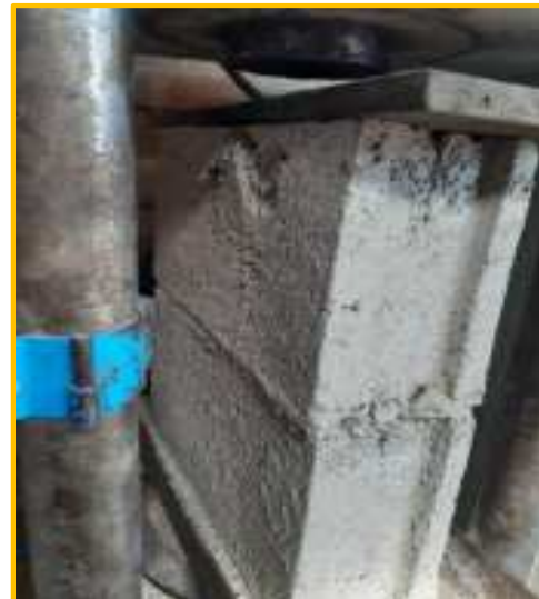
Rotura de pilas – 20% CCA.
