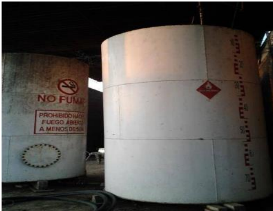
Figura 24. Tanque de almacenamiento de alcohol 96° y 95° GL.
