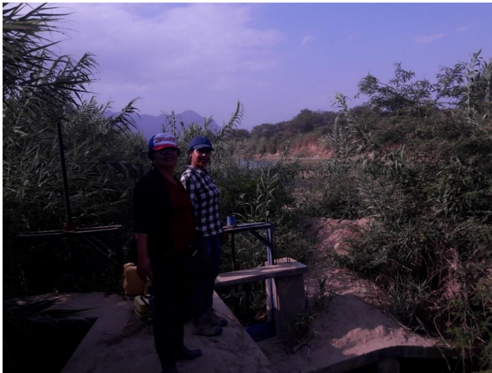
Estructura existente en mal estado y sin funcionamiento.
