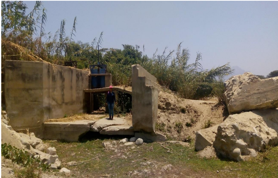
Restos de la Bocatoma existente.
