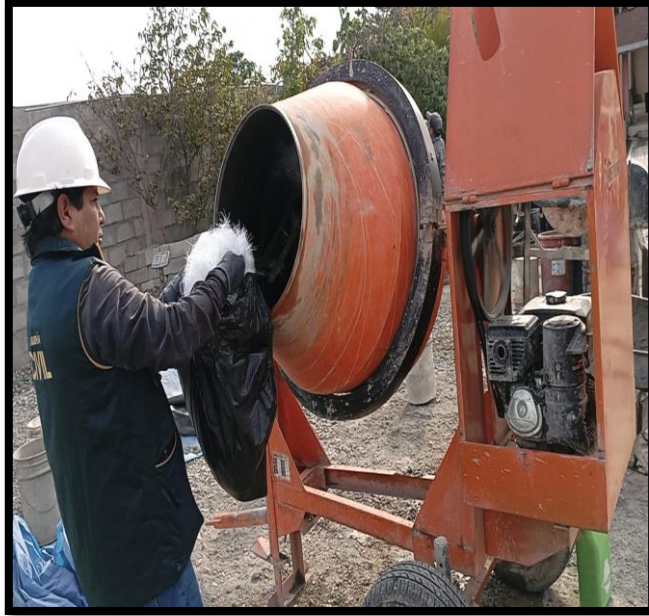
Fig. 28. Realización de la mezcla de concreto con adición de fibra de vidrio
