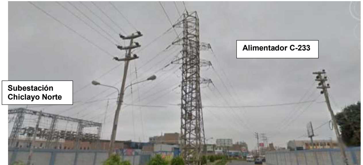
Salida del Alimentador C-233 de la Subestación Chiclayo Norte
