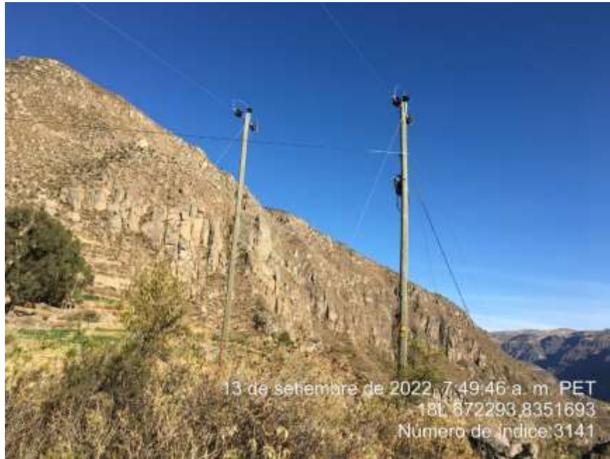
Figura 8: Fotografía real de un SER primario monofásico de dos hilos.
