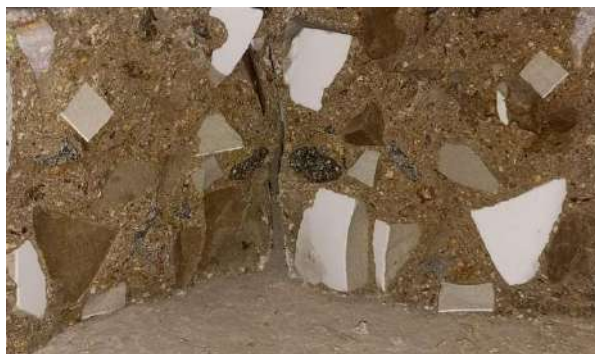
Fig. 34 Detalle de la rotura del concreto con cerámica sanitaria.
