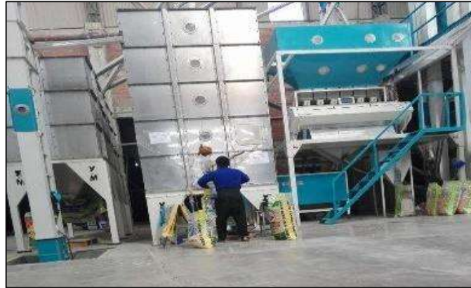
Figura 19. Tolva de recepción del producto terminado
