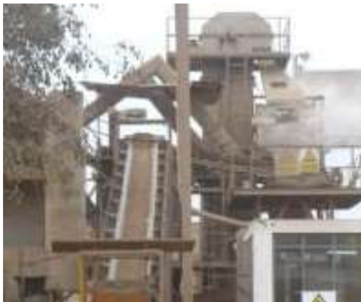
Figura 16. Sistema de Molienda
