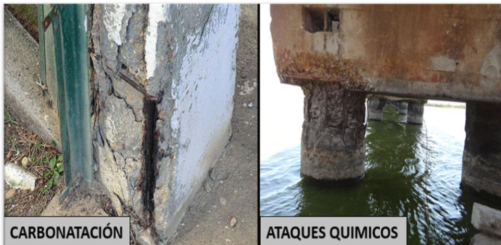
Fig. 2 Ataque por carbonatación y ataques químicos al concreto
