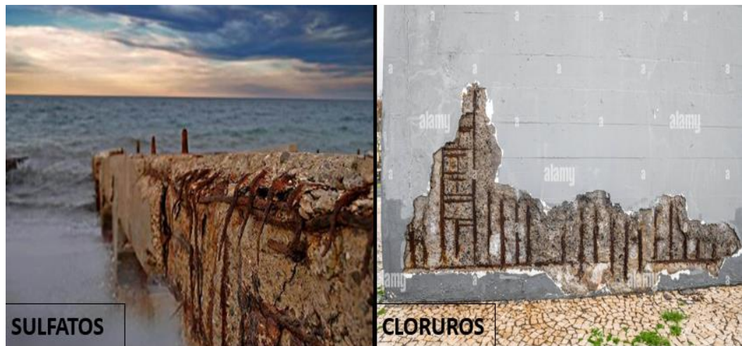
Fig. 1 Agresión por sulfato y cloruros al concreto
