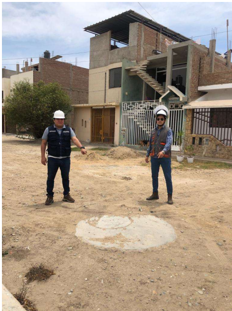
Fig. 15. Buzón que colapsa N° 02.
