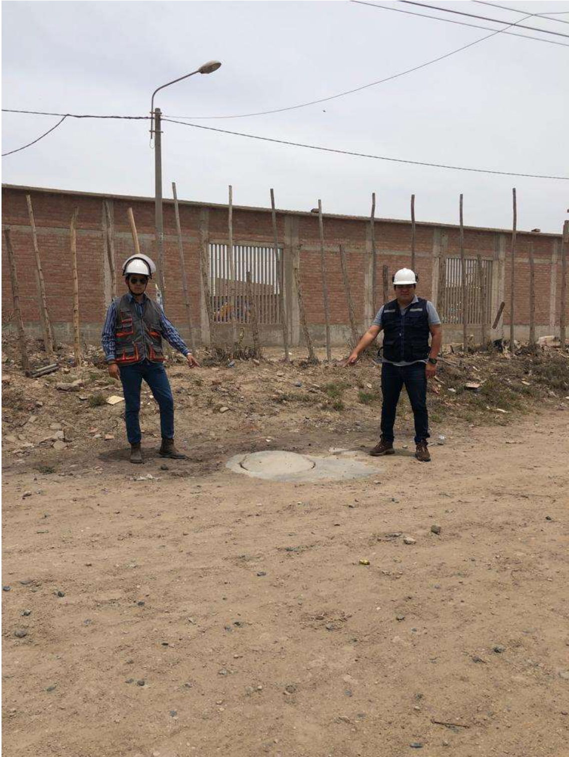
Fig. 30. Evaluación de buzón que colapsa en el actual sistema de alcantarillado.
