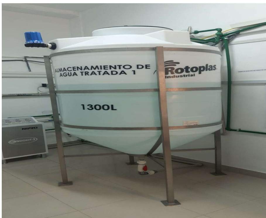
Ilustración 7 almacenamiento de agua tratada
