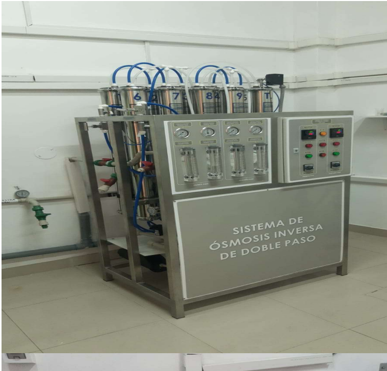
Ilustración 2 sistema de osmosis inversa
