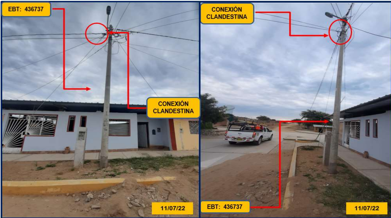
Fig 7. Evidencia fotográfica de conexión clandestina.
