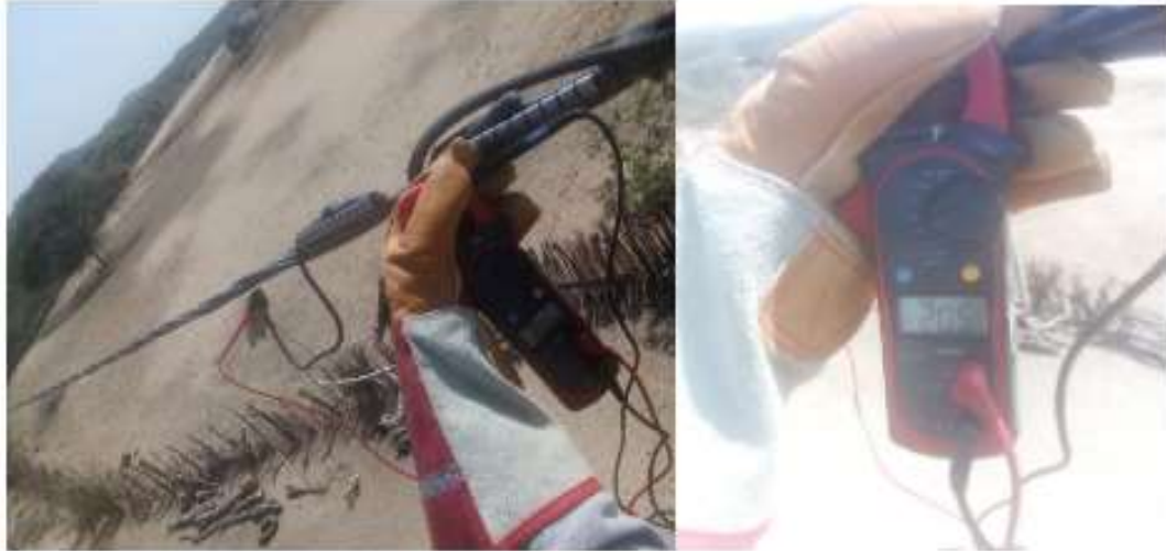
Fig 4. Medición de voltaje en circuito.
