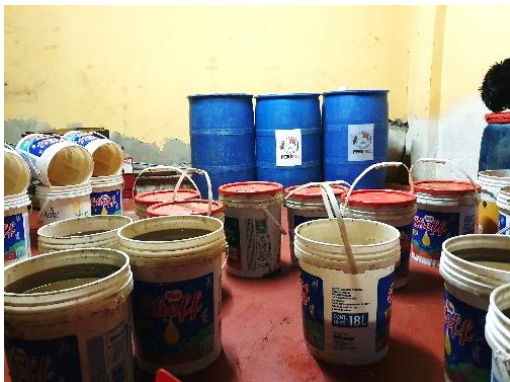
Paredes en condiciones inadecuadas
