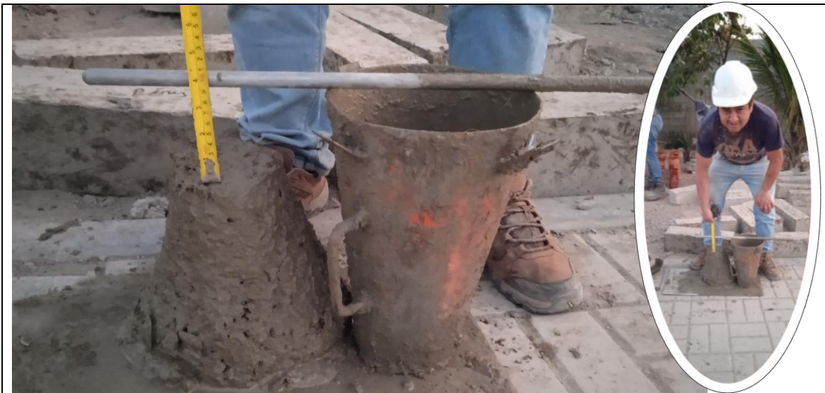
Fotografía 03. Se realizó el ensayo de asentamiento en el cono de abrahams, teniendo una consistencia plástica de 4”.
