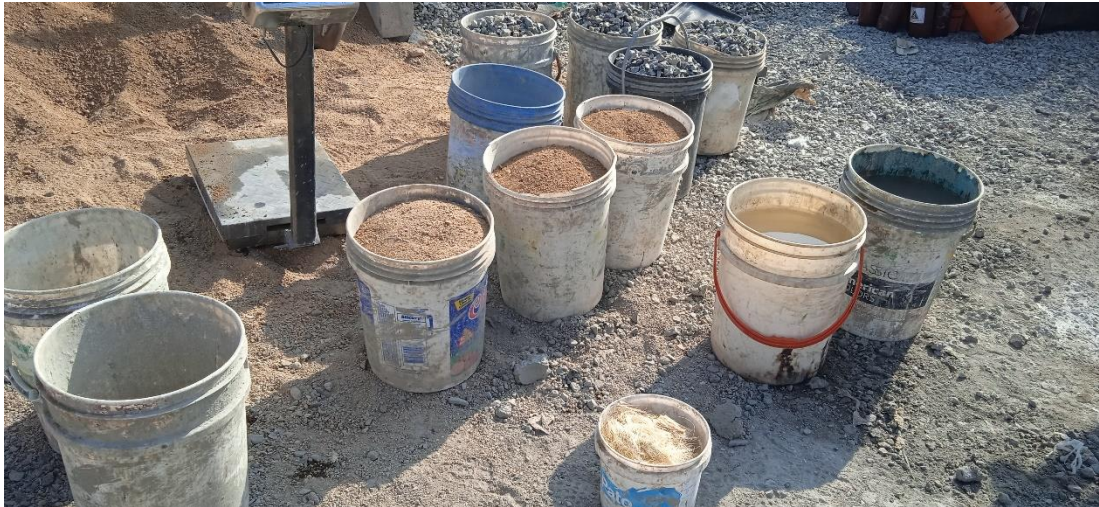
Fotografía 01. Se observa los materiales para la elaboración de concreto, agregado fino, agregado grueso, cemento con la adición de fibra de sisal por tanda.
