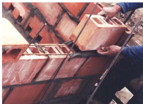
Fig. 5. Asentamiento de albañilería armada. [39]
