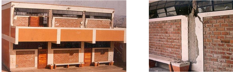
Fig. 15. Falla por columna corta en edificios escolares peruanos. [42]
