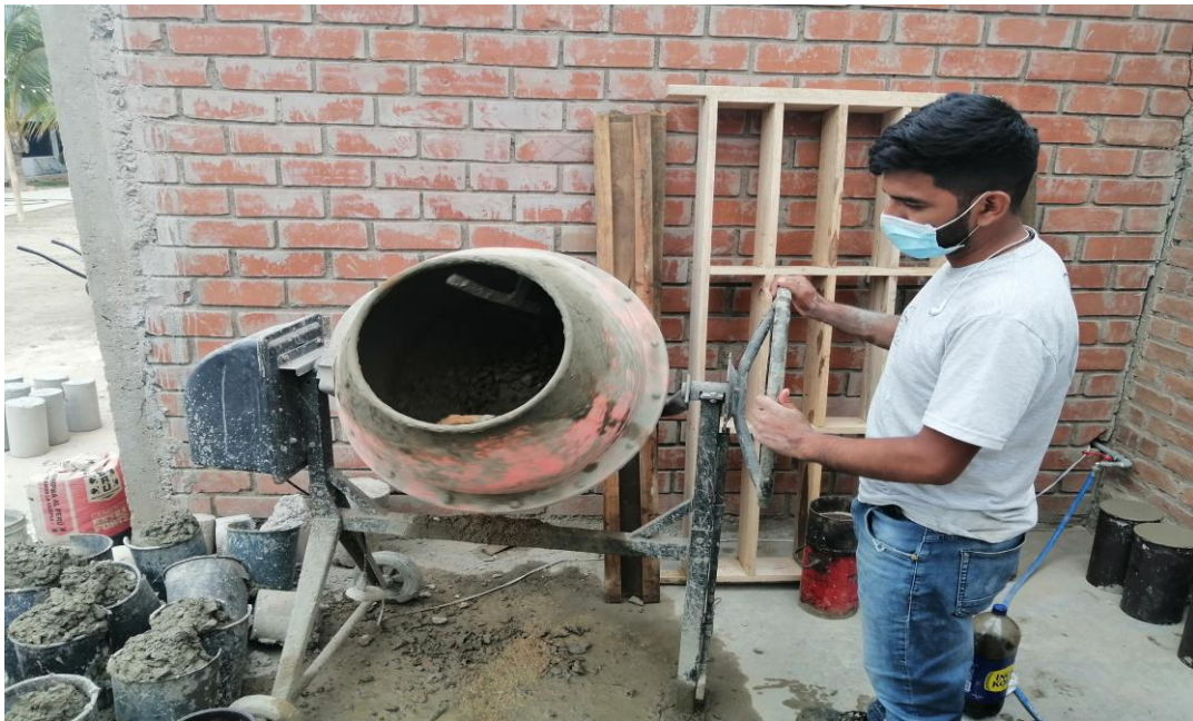
Mezclado en trompo para el diseño de mezcla de prueba concreto convencional
