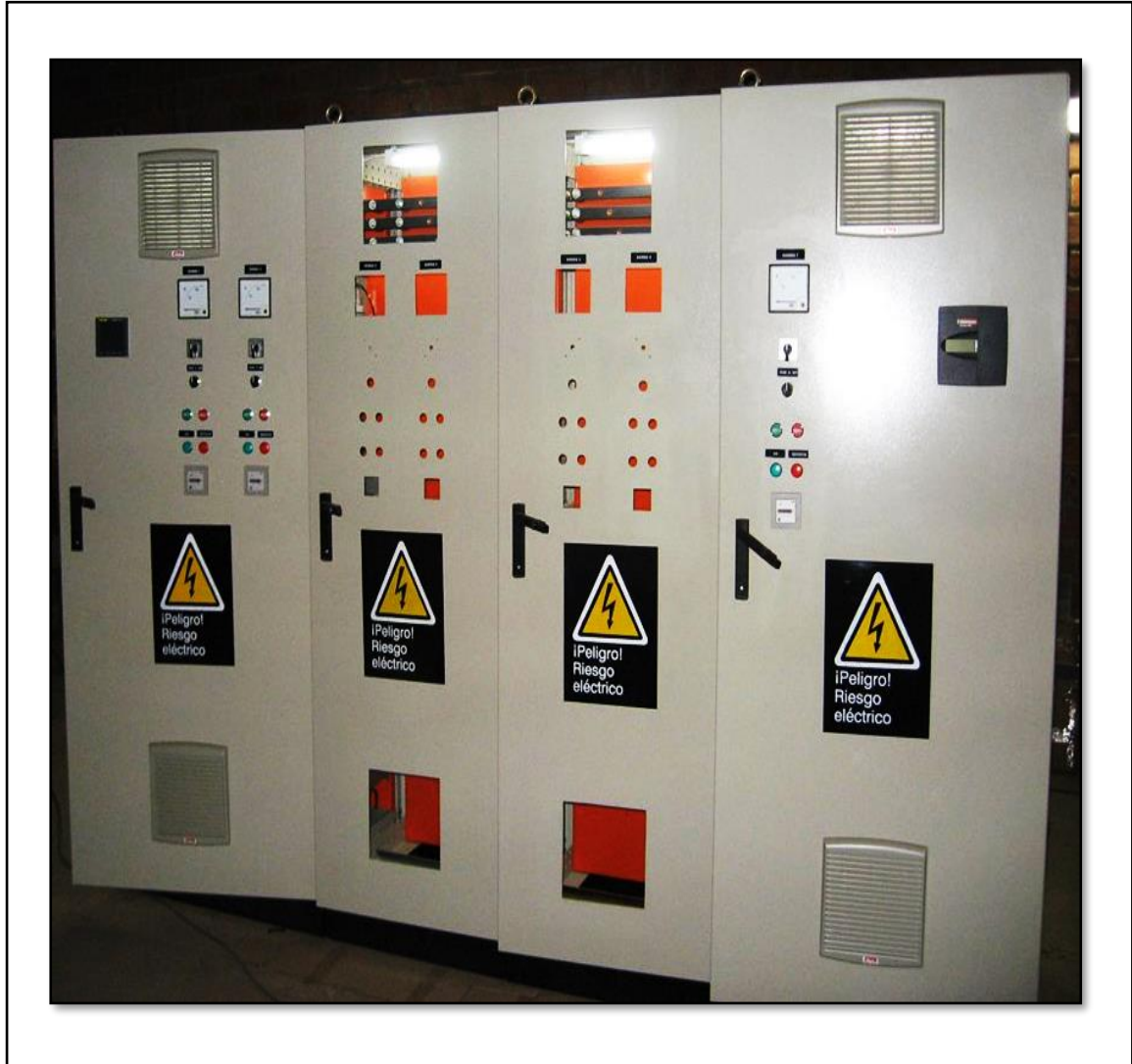
Figura 12: Integración de tableros Eléctricos
