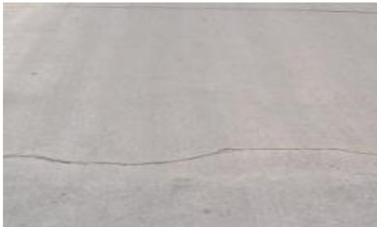
Figura 7. Grieta de pista con asfalto.
