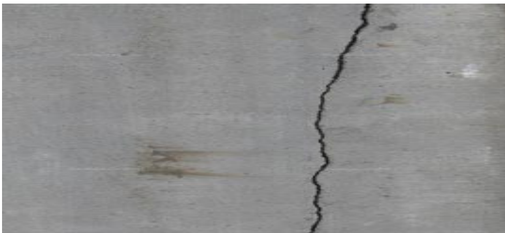
Figura 5. Grieta longitudinal. Fuente (Construcción de asfalto, 2014)
