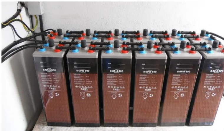
Figura 9 Conjunto de baterías
