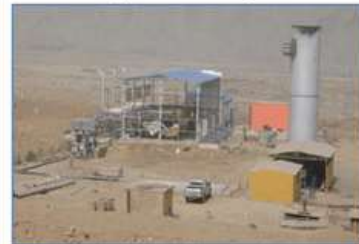
Central Termoeléctrica Huaycoloro
