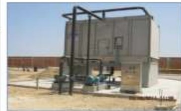
Torre de Enfriamiento de la Planta
