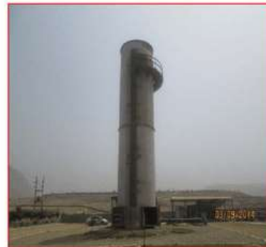
Estación de quemado de gas
