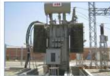
Transformador ABB de 42 MVA 60/13,8 kV
