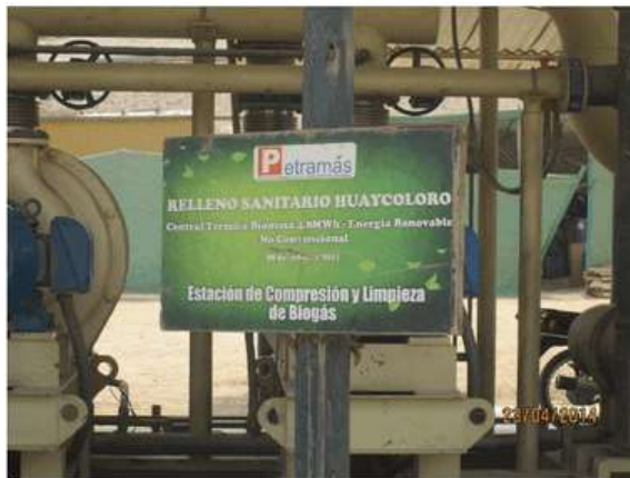
Sistema de compresión y limpieza de Biogás
