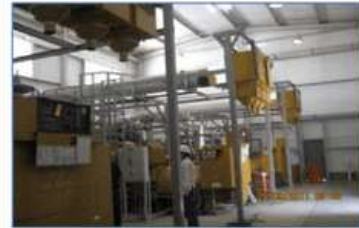
Grupos de Generación 3 x 1,6 MW
