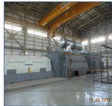
Unidad de Generación (Turbina a vapor)
