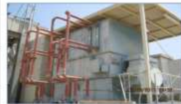
Generador Eléctrico ABB de 30 MW
