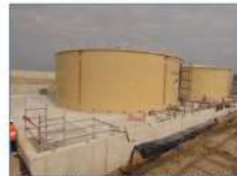
Tanques de almacenamiento de combustible Diesel B5
