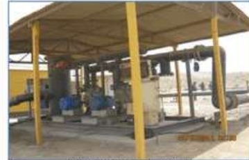
Planta de tratamiento de Biogás
