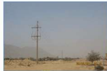
Línea de subtransmisión 22,9 kV
