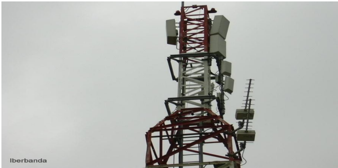
Figura 11. Estación base Wimax. Fuente: (Iberbanda,2016)
