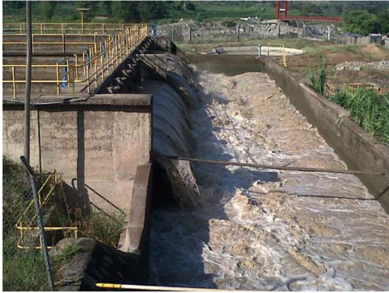
FOTO: Nº3. DESCRIPCION: BOCATOMA-RACARUMI.
