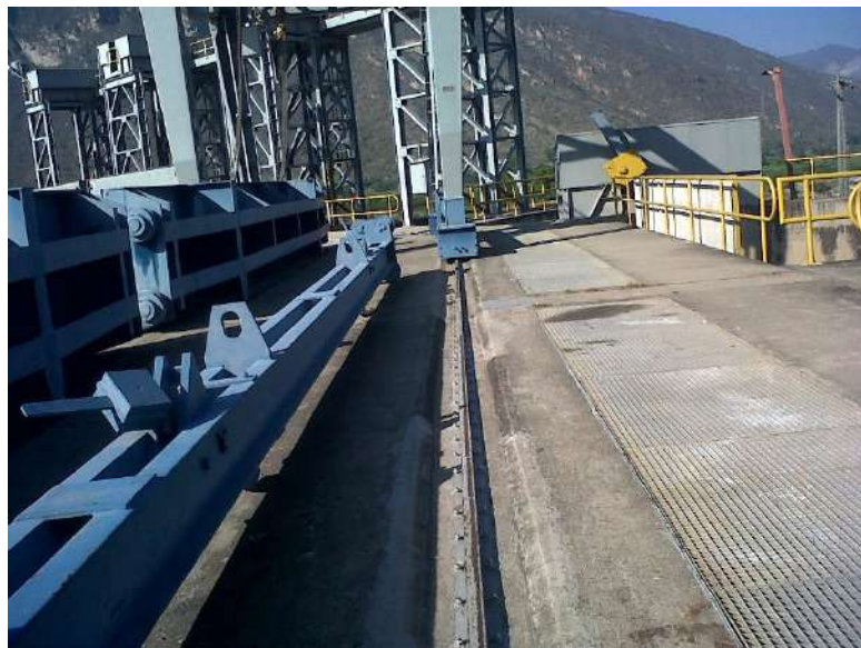
FOTO: Nº4. DESCRIPCION: BOCATOMA-RACARUMI.
