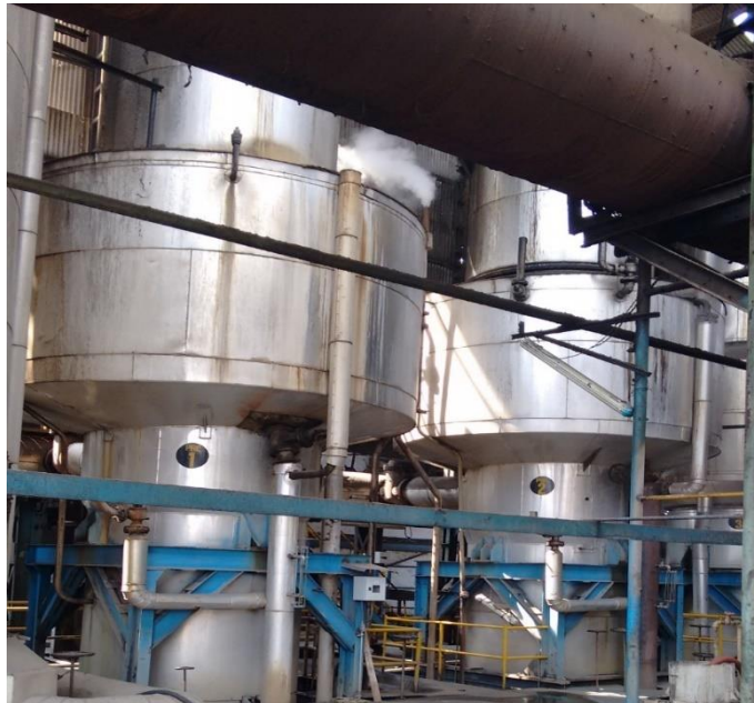
Figura N o 35 Tanques Pre Evaporadores
