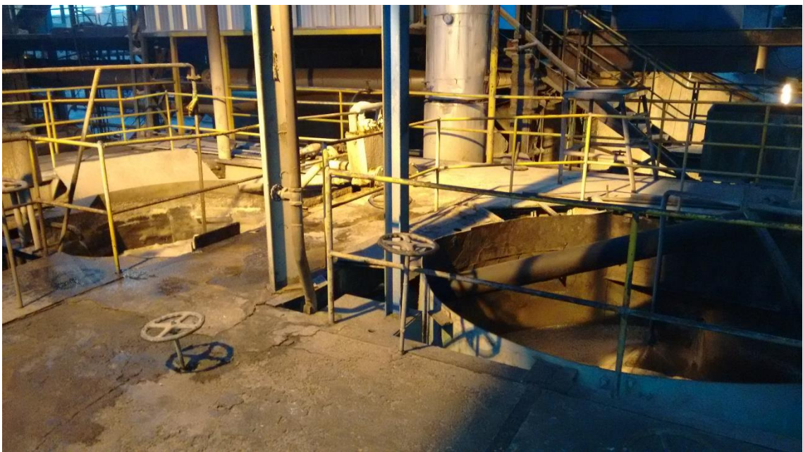
Figura N o 31 Tanques de Jugo encalado
