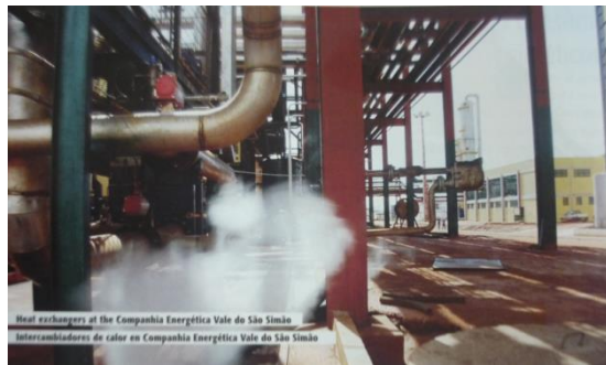
Figura 2: Intercambiadores de calor en la compañía energética vale do sãosimão
