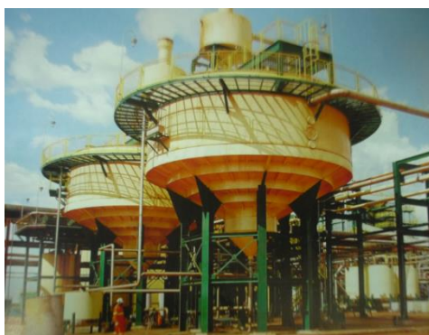
Figura 1: Tanque de dosificación de cal. equipamiento en bloques, como en una línea modular.
