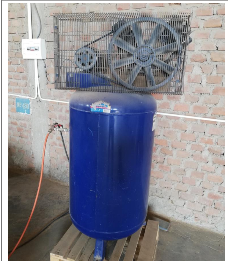
Figura 20. Comprensora de aire.
