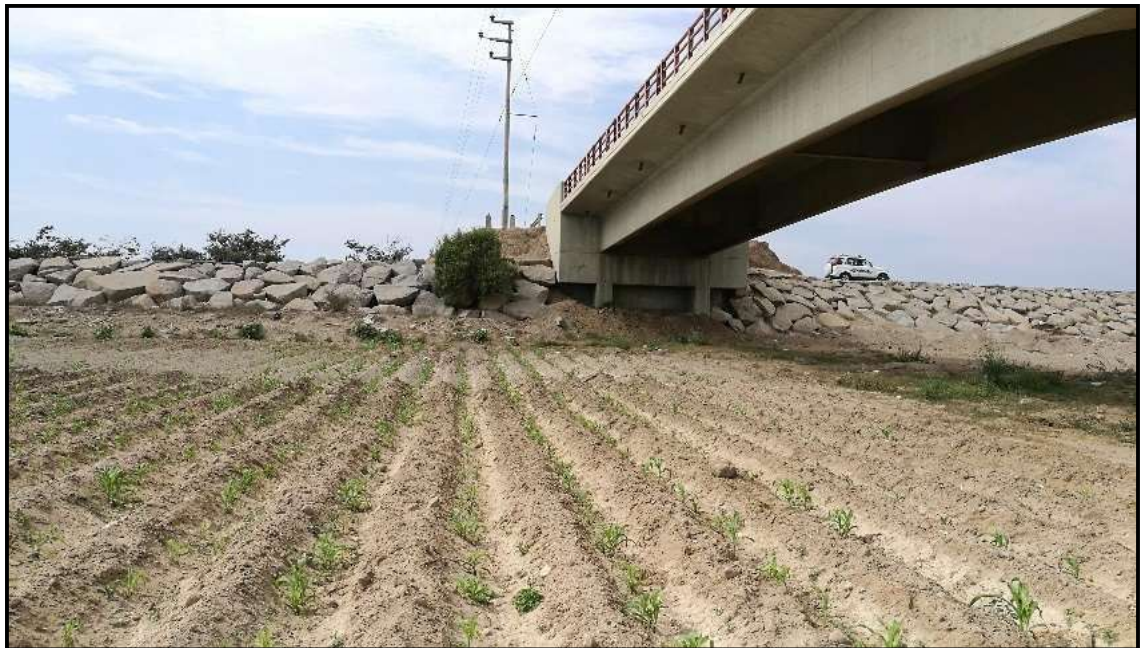
Figura n° 6: Zona de protección ante la corriente del río Chancay.
