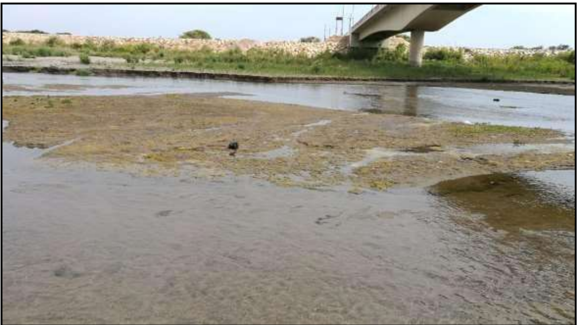
Figura n° 8: Socavación general del río y sedimentación aguas arriba y aguas abajo del puente Eten-Monsefú, año 2019.
