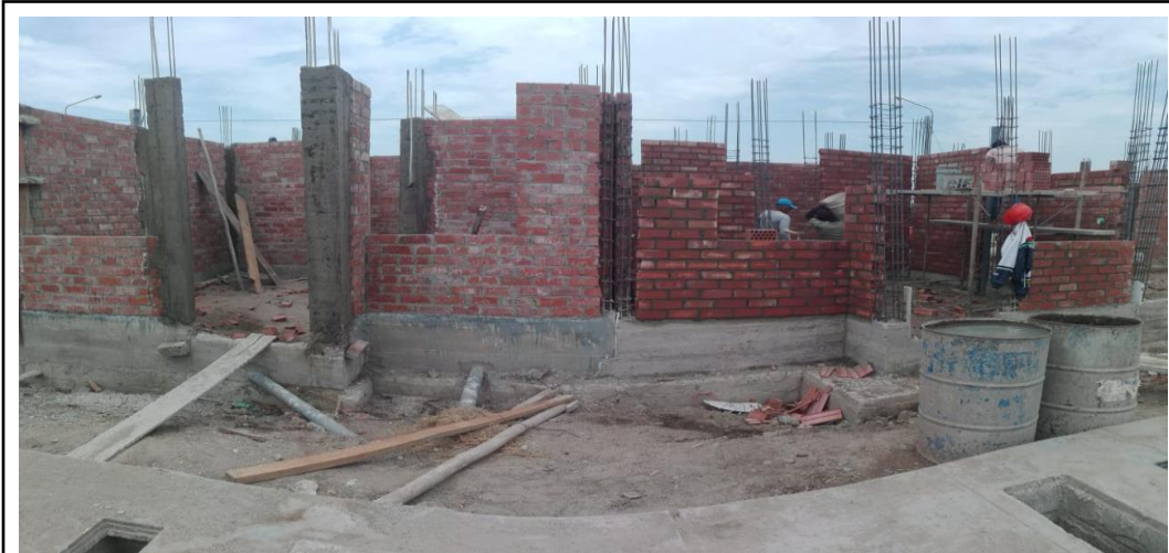
Figura 17. Fotografía de obra mostrando los materiales desperdiciados.
