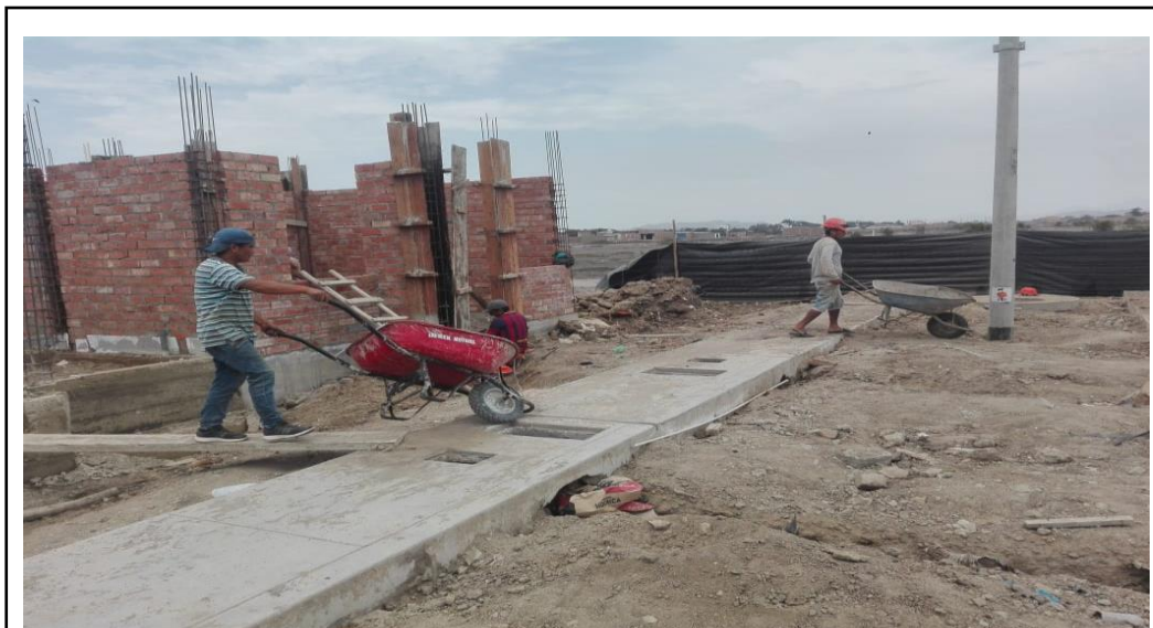
Figura 18. Fotografía de obra mostrando problemas de desperdicios.
