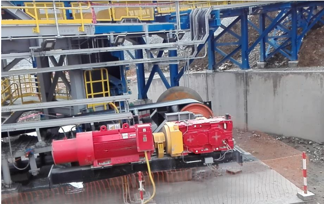
Figura 45. Motor de Accionamiento – Lado Cola (Pruebas en vacío)
