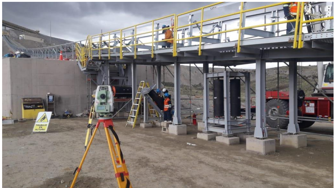
Figura 41. Volteadores de faja – Lado Cola (Controles topográficos)
