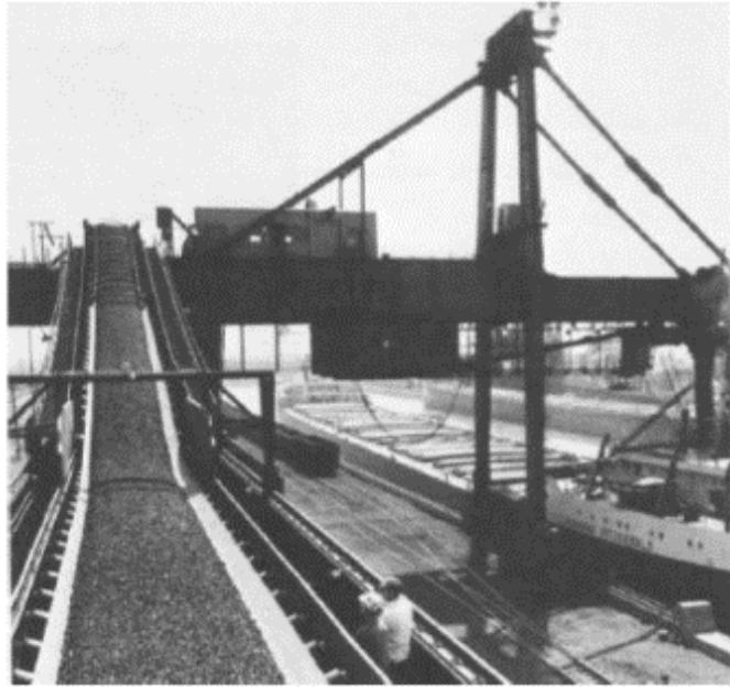
Figura 5. Transportador de alta capacidad de transporte de carbón.
