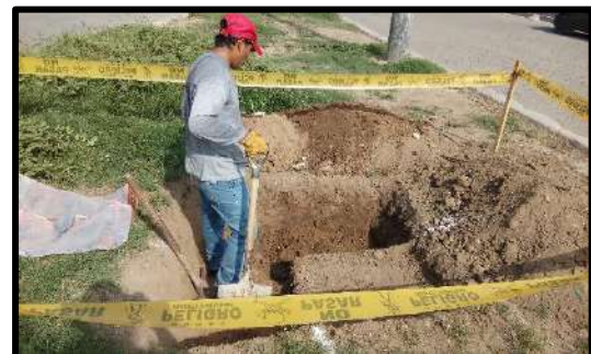
Figura 102. Se puede apreciar en esta foto la realizacion de la primera calicata con respectiva medida de seguridad.
