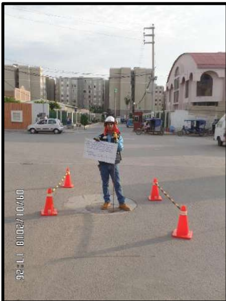
Figura 79. Se puede apreciar otra toma de la realización de mediciones de altura en el buzón ubicado en la Av. El Progreso y Av. Victor Andres Belaunde
