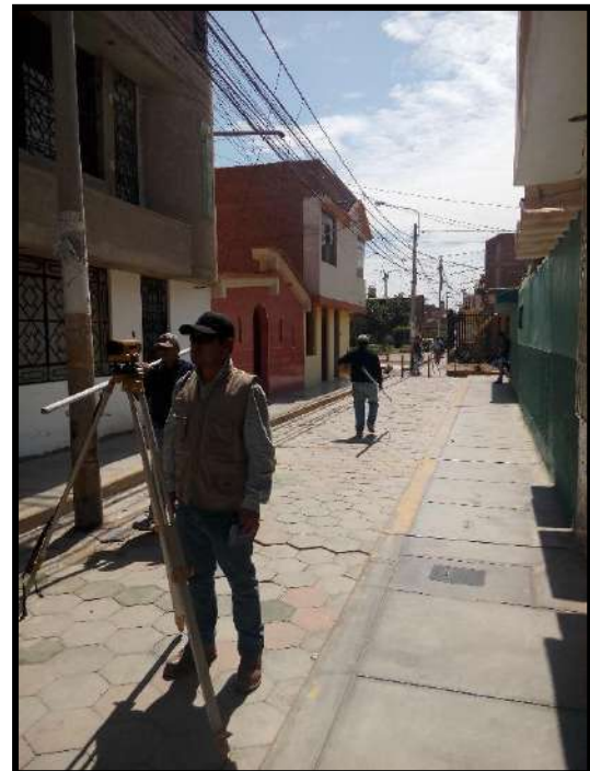
Figura 42. Otra toma de lectura de los buzones existentes por el Pasaje Manuel Vivanco.
