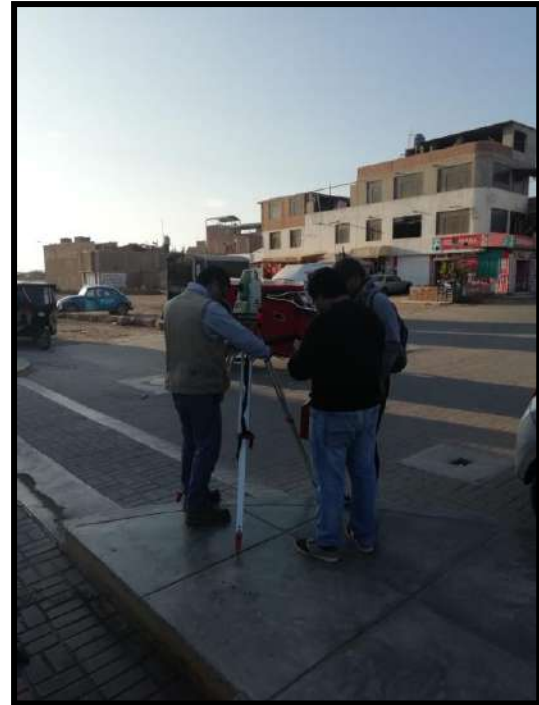
Figura 33. Cambio de estación PL-08 para seguir con el cierre de la poligonal cerrada, entre Av. Del Progreso y Av. Belaunde.
