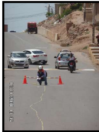
Figura 73. Se puede apreciar otra toma de la realización de mediciones a distancia con wincha en el buzón ubicado entre la Calle Refunio Echenique y Pasaje Pedro Diaz calderon.
