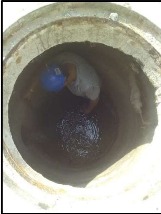
Figura 50. Se puede apreciar otra vista de la limpieza del buzón interno por parte del personal de Epsel en la calle mariategui con un gran porcentaje de sedimentos.
