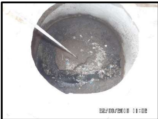
Figura 95. Se puede apreciar en esta toma el atoro que puede ser revelado en cualquier instante en la Ca. Cautivas.
