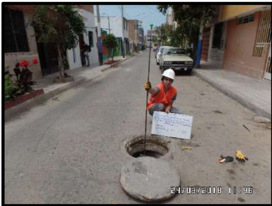
Figura 90. Se puede apreciar otra toma de la realización de mediciones de altura en el buzón ubicado en la Ca. Luis de Orbegoso y Psj. Antonio Pezet.
