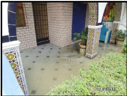
Figura 47. Se puede apreciar que en la caja de registro de desagüe de la vivienda, es sumergida las aguas residuales.
