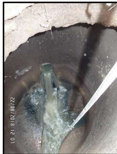
Figura 97. Se puede apreciar en esta toma el sentido de flujo de las aguas residuales.
