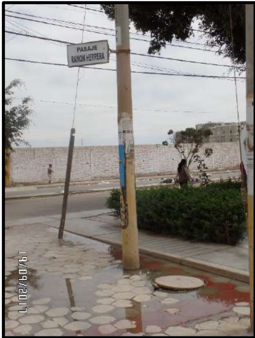
Figura 46. Se puede apreciar que en el pasaje Ramon Herrera, donde el buzón capta todas las aguas residuales
