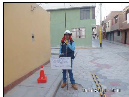
Figura 85. Se puede apreciar otra toma de la realización de mediciones de altura en el buzón ubicado en el Psj Manuel Galvez.
